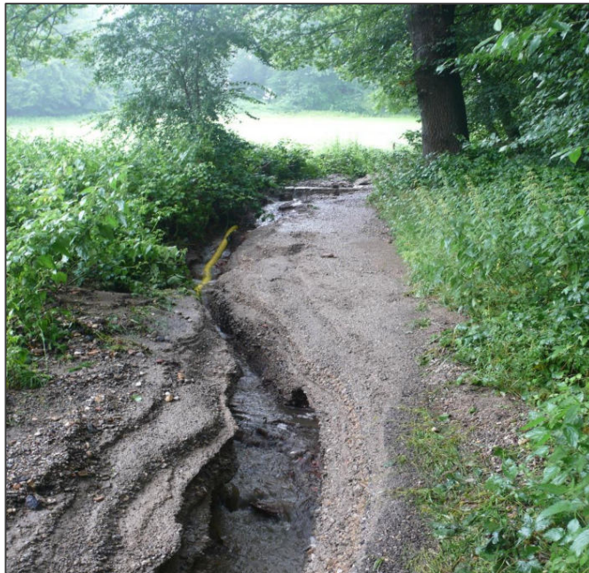
Abb. 60: Erosionsrinne, innerhalb von zwei Tagen entstanden.
