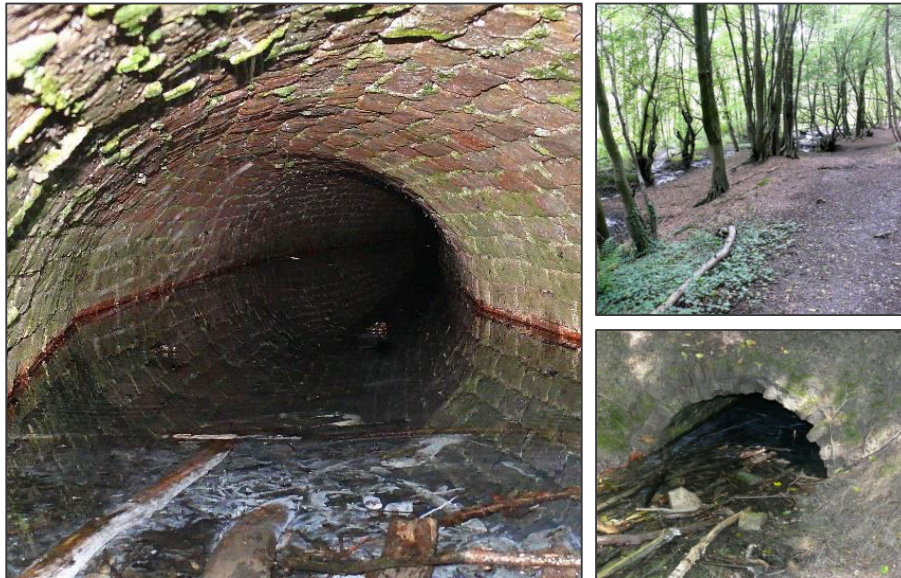
Abb. 30: Mundloch eines Abwasserstollens der Grube Ath zwischen Bardenberger Mühle und Burg Wilhelmstein.
