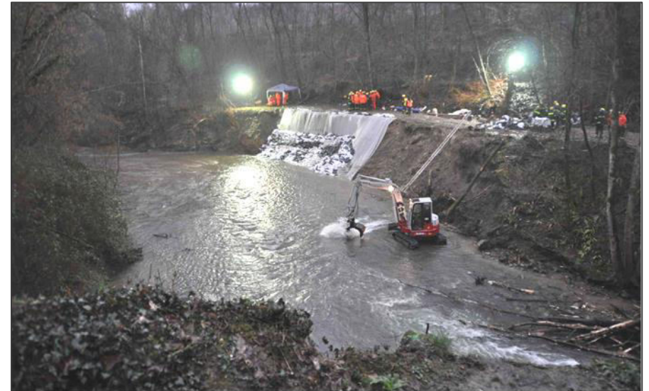
Abb. 56: Unterspülung einer Abwasserleitung am 12. März 2019.
